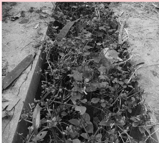
Gambar 10 Sistem drainase di lingkungan data center
