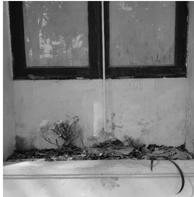
Gambar 9 Dinding di luar data center
