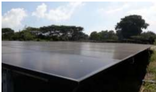
Gambar 4. 4 Gambar Debu dan Kotoran pada Panel Surya Ground Mounted
