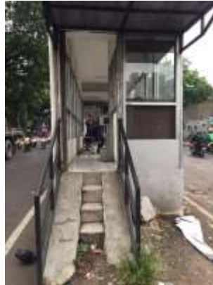
Gambar 1 Kondisi Halte TMB di Jalan Elang Sumber: Dokumentasi Penulis (2019)
