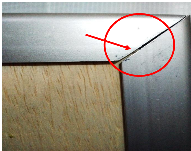
Gambar I-2. Pemotongan Sambungan Yang Tidak Presisi.
