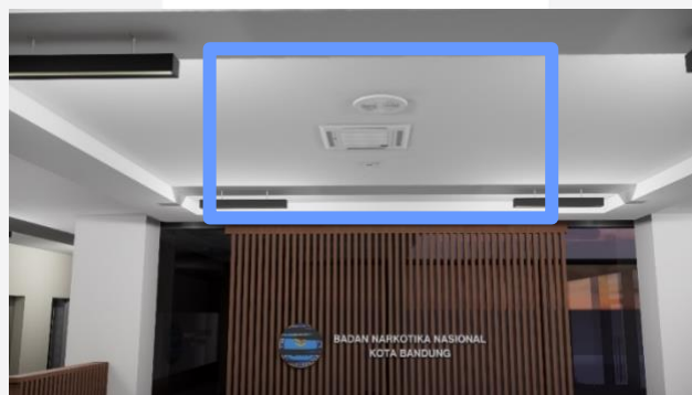
Gambar 4.14 Penggunaan AC Casette Pada Ruang Pelayanan.
