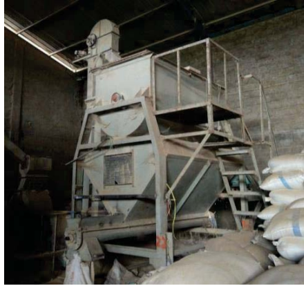
Gambar 3. Kondisi eksisting mesin Hammer Mill CV.XYZ
