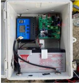
GAMBAR 3.1 ISI BOX MIKROKONTROLER
