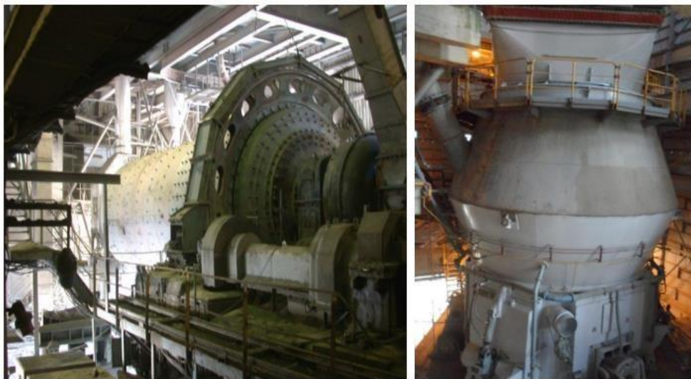
Gambar I. 3 Mesin Finish mill Sumber: PT Semen Tonasa (2021)
