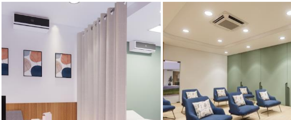
Gambar 4. 12 Pengaplikasian Penghawaan Buatan dengan AC split dan central lantai 1 dan 2 Sumber: Dokumentasi Pribadi, 2023
