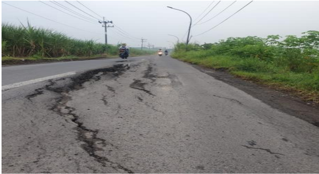
Gambar 1.1 Jalanan Rusak di Kabupaten Gresik
