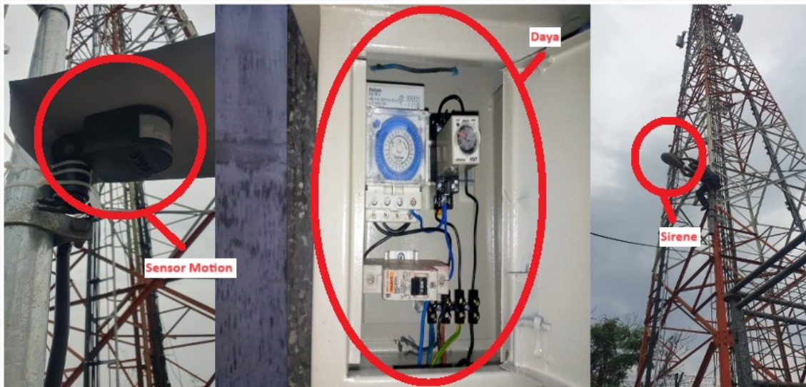
Gambar 1.1 Sistem Surveillance Yang Sebelumnya Sudah Terpasang
