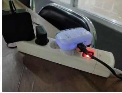
Gambar 13. Reapeter yang digunakan untuk menangkap sinyal ISP yang tidak bisa dijangkau oleh LAN
