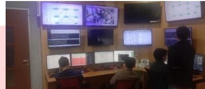
Gambar 3.1 Meja Kerja PC Staff NOC West, Central dan East
