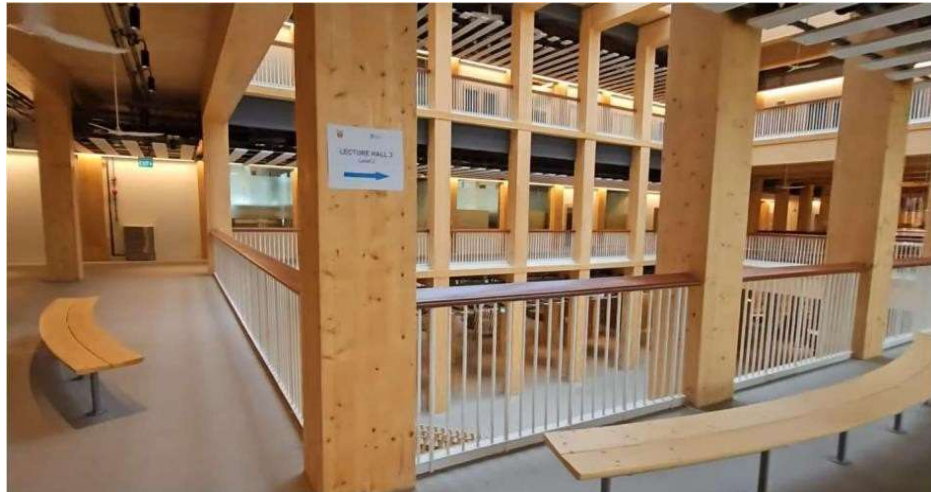
Gambar 1. 3 Kondisi Penggunaan Lampu Pada Gedung Gaia
